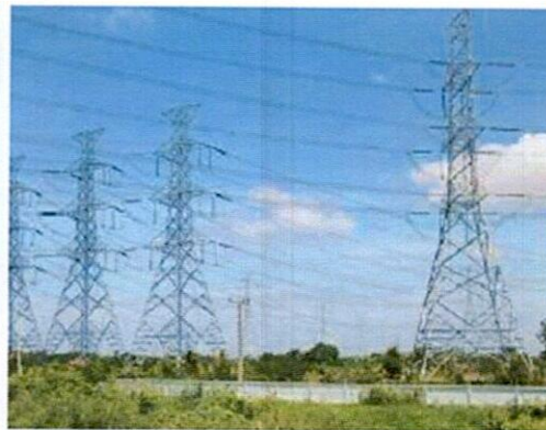
เสาไฟฟ้า
