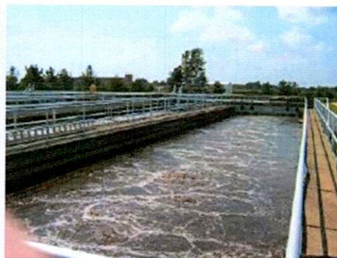
บ่อบำบัดน้ำเสีย
